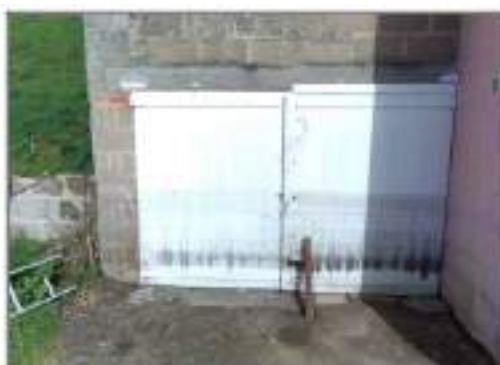
Vue rapprochée (=détail du repère)
